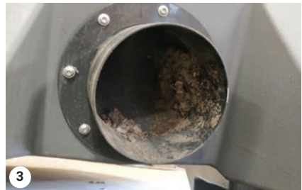
Einlass in den Wasserbehälter
