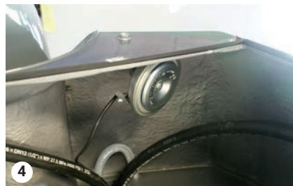
Stecker am Alarm prüfen
