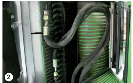
Die Kühler mit sauberem Wasser waschen
