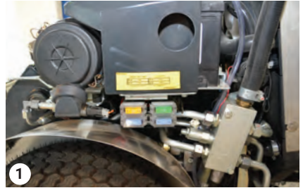
60 A JF15 generator - 60 A JF1 strømforsyning, sikringsboks 20 A JF2 nødledning - 30 A JF3 motoreffekt
